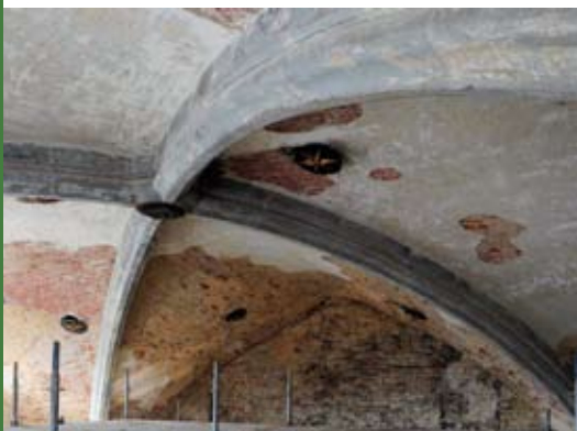
Transept, voûte sur croisée d'ogives millésimée 1622. Dégagement de l'enduit laissant apparaître un faux appareil de briques régulières. G. Focant, DPat © MRW
